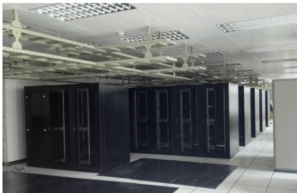
华为山东大数据中心
